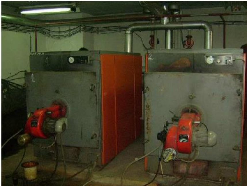
sl. 3.7.a) toplovodni kotlovi za grijanje objekata
