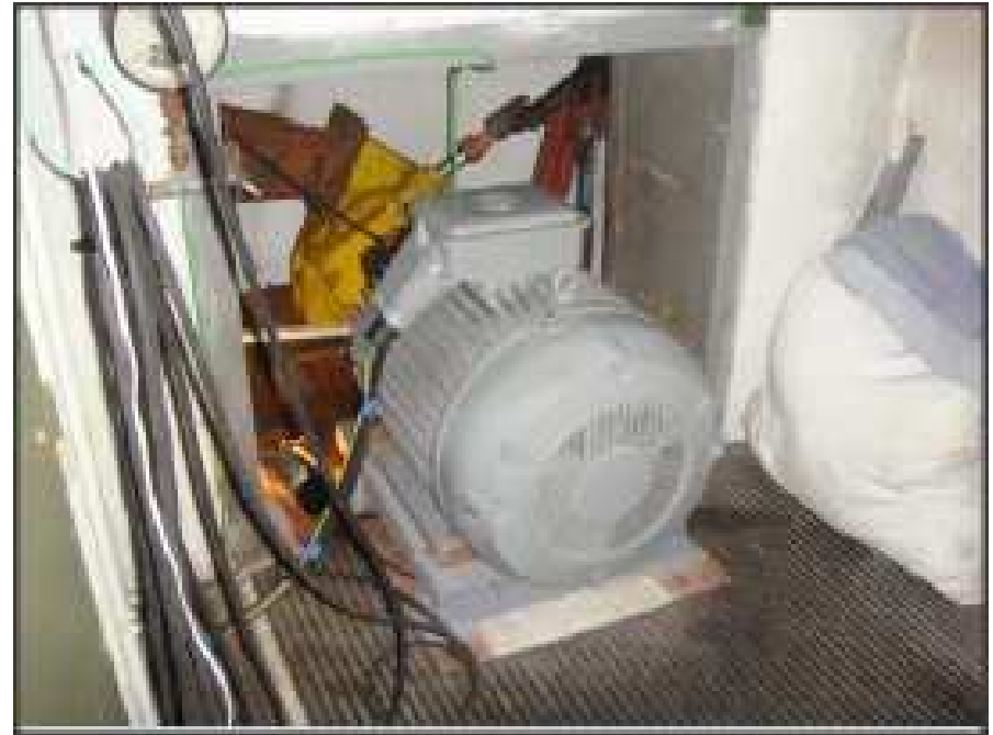
Horni Maršov (Češka): Cross flow, 15 kW
