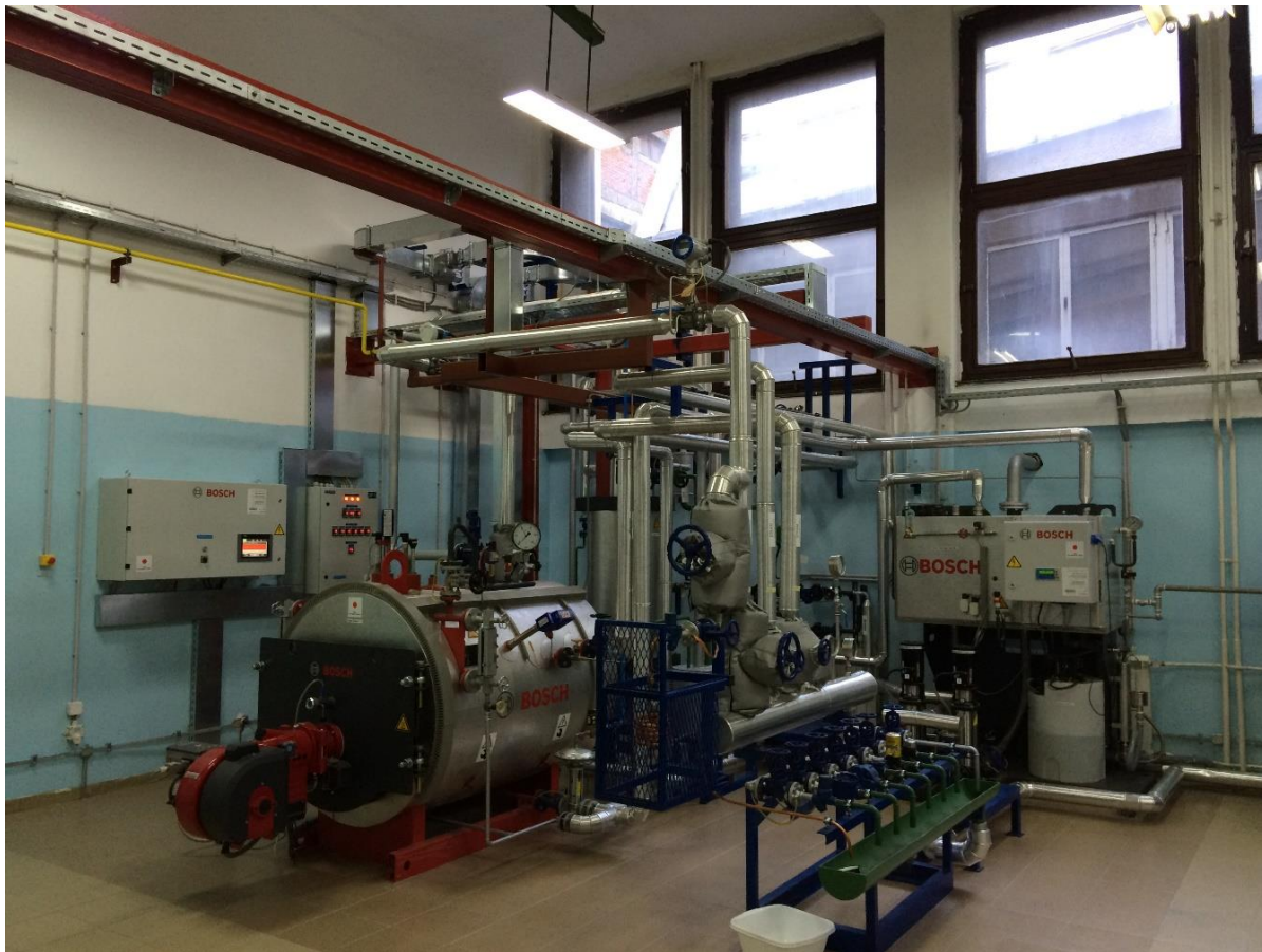
Котловско постројење, одвајачи кондензата и изолација
